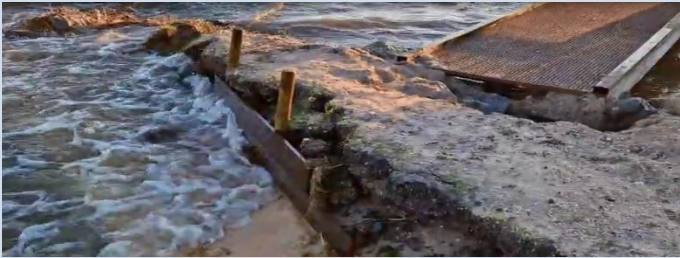
Maandagmiddag 8 januari 2024: Een provisorische golfbreker welke niet bleek opgewassen tegen het water.
